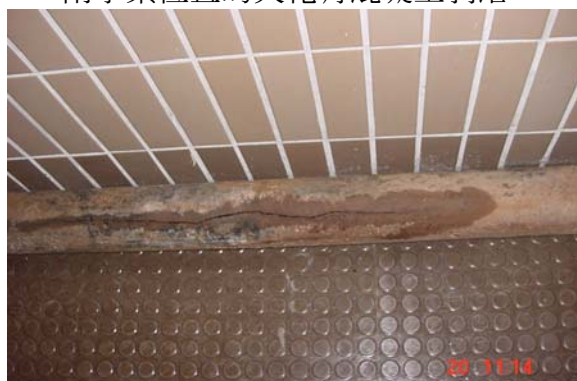
雨水渠出現裂痕
