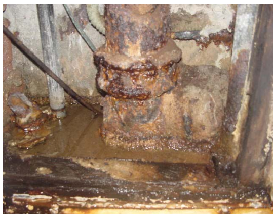
穢水直渠嚴重銹蝕，並有滲漏現象
