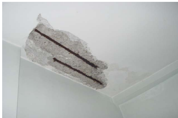
雨水渠位置的天花有混凝土剝落
