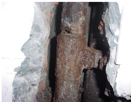
公眾氣喉霉爛，並有漏水現象
