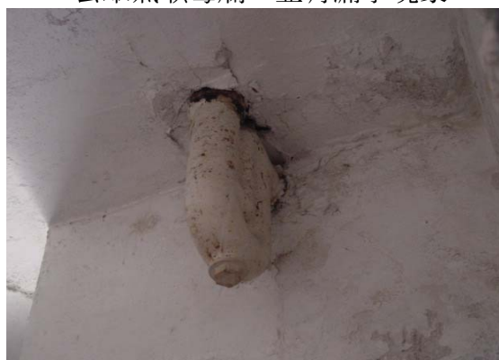
地台去水隔氣配件生銹，而周邊位置有滲漏及油漆剝落
